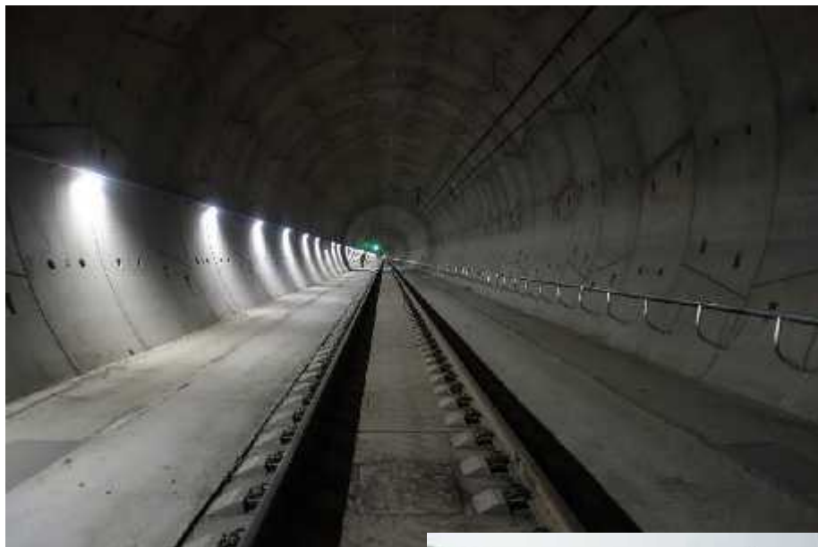
Dokončená PJD v tunelu Ejpovice
